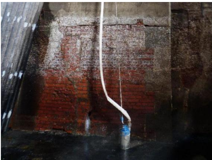
Abbildung 16: Mauerwerk im Unterhaupt mit wasserführendem Riss
