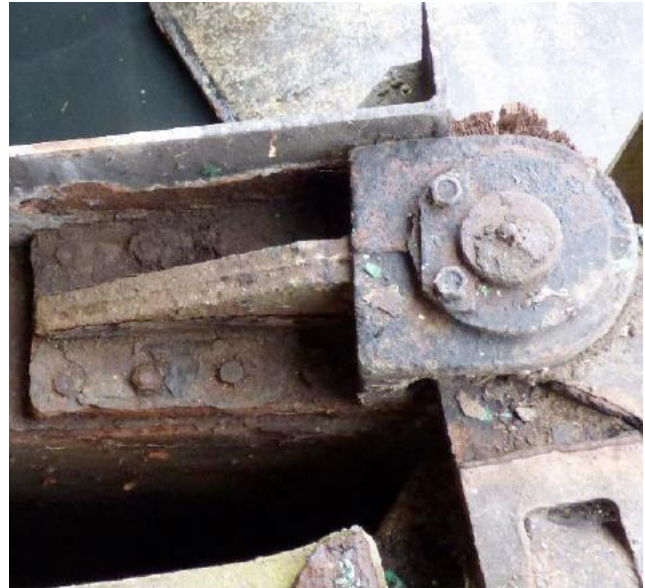
Abbildung 18: Korrodierte Halslager der Fluttore
